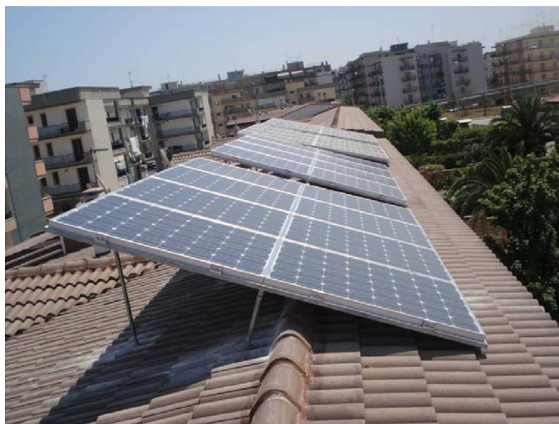
Figura 10 - Esempio di installazione non idonea alla classificazione dell'impianto fotovoltaico nella categoria "su edifici" – Motivazione: i moduli non rispettano la geometria della falda di copertura
